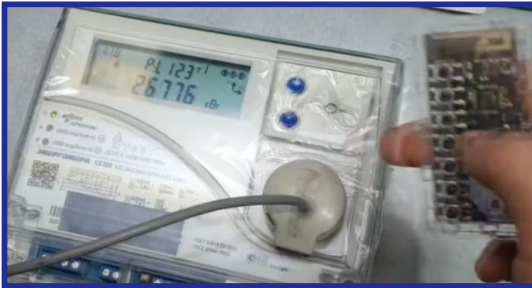
Электропотребление в заводском режиме 2,678 кВт
